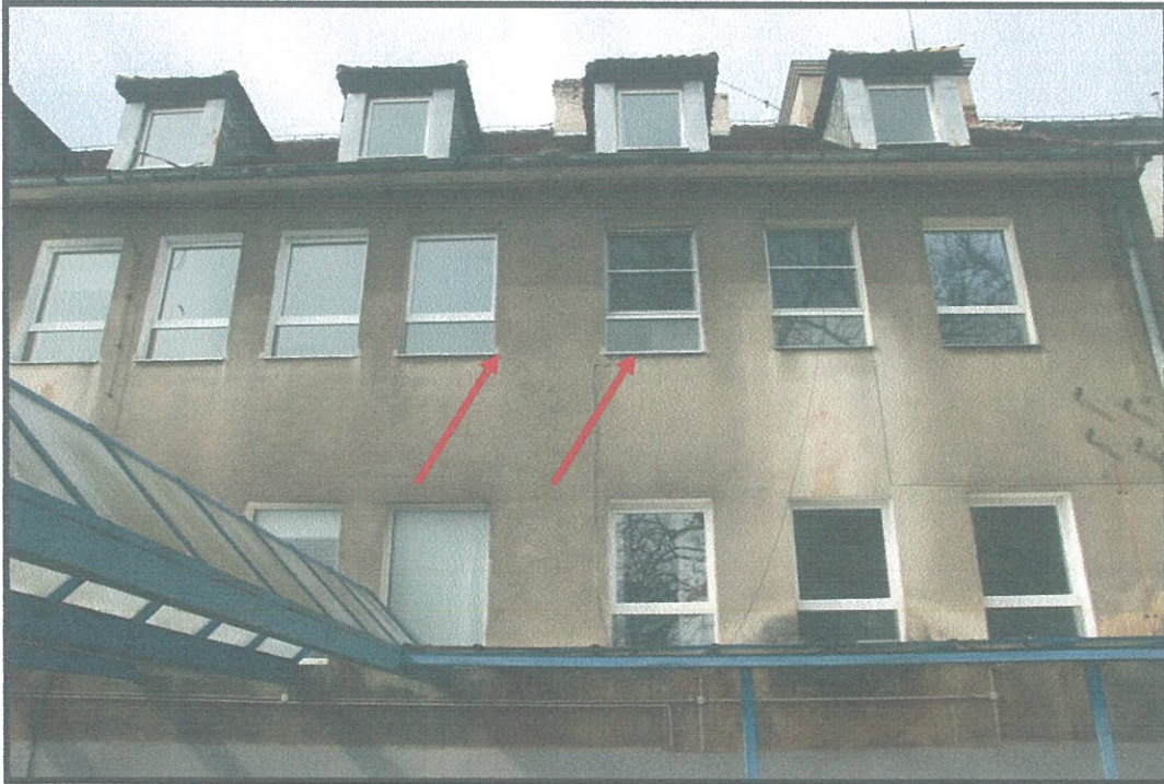
Fotografia 2: Widok na wschodnią elewację budynku A. Czerwoną strzałką zaznaczono miejsca gniazdowania wróbla ( Passer domesticus ).
