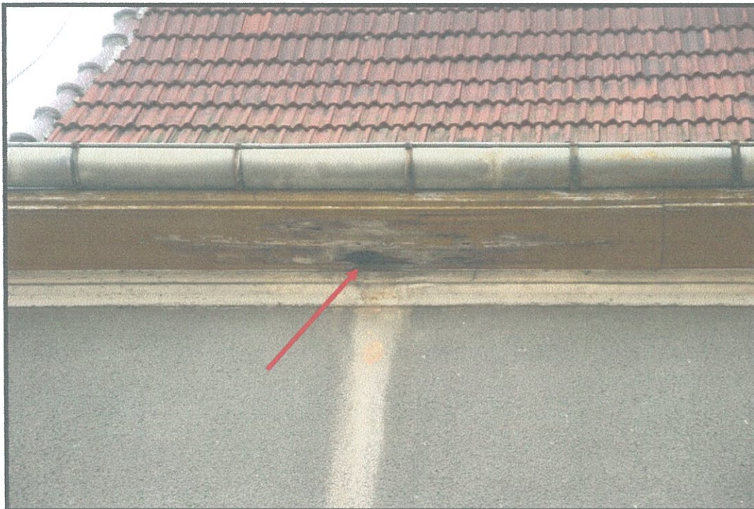
Fotografia 5: Widok na szczelinę w podbitce, miejsce to należy zabezpieczyć za pomocą drobnoczkowej siatki wykonanej z tworzyw sztucznych.
