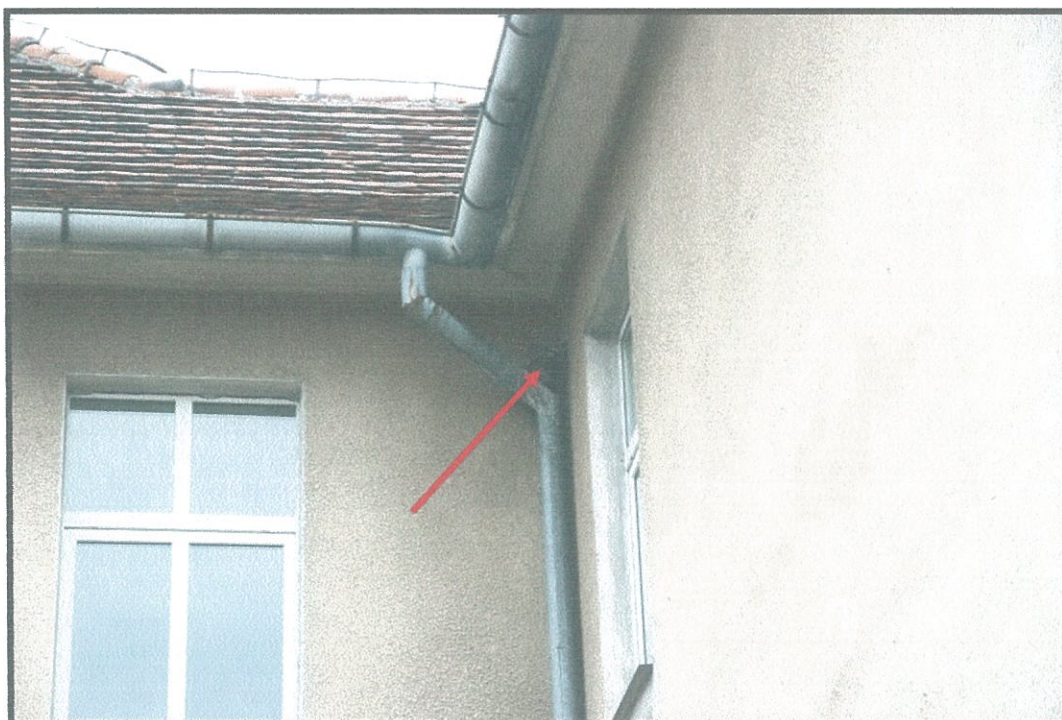
Fotografia 7: Widok na przestrzeń za rynną na zachodniej elewacji zajmowaną przez gołębie.
