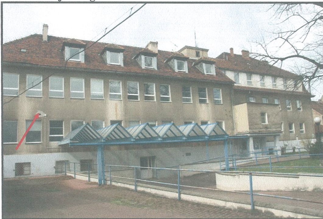
Fotografia 1: Widok na wschodnią elewację budynku. Czerwoną strzałką zaznaczono miejsce potencjalnego gniazdowania ptaków. Szczelinę tę należy zabezpieczyć za pomocą siatki drobnoczkowej lub zaprawy murarskiej.
