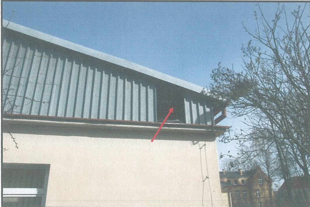
Fotografia 4: Na zdjęciu widoczny ubytek w części zachodniej ściany szczytowej. Miejsce to bezwzględnie należy zabezpieczyć w sposób uniemożliwiający dostanie się do środka ptaków lub nietoperzy.
