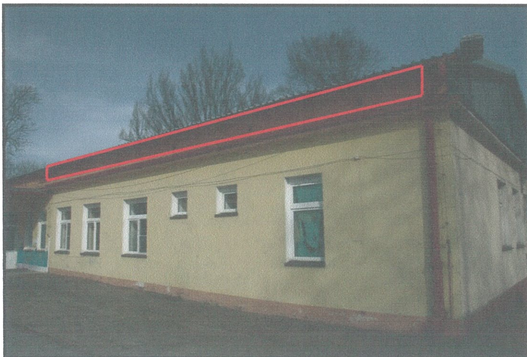
Fotografia 2: Widok na zachodnią elewację budynku wraz z zaznaczoną strefą w której znajdują się niezabezpieczone otwory prowadzące do przestrzeni poddasza. Te oraz wszystkie inne podobne otwory należy zabezpieczyć zgodnie z zapisami punktu 8.2
